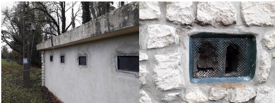
Figure 10 : Orifices de ventilation à l'arrière du bâtiment d'exploitation (gauche), orifice de ventilation endommagé sur la partie latérale du bâtiment d'exploitation (droite)
