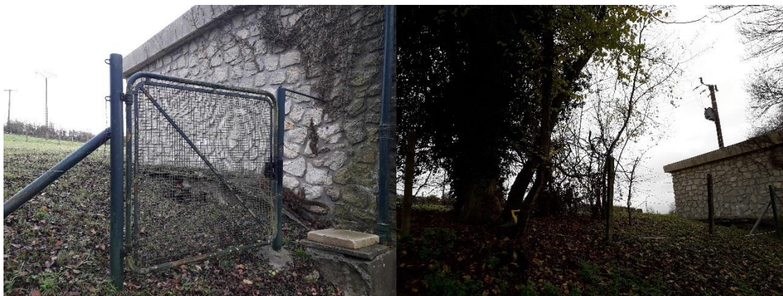
Figure 9 : Portail d'accès au PPI (gauche) et vue d'une portion de clôture endommagée par un tronc d'arbre (droite)
