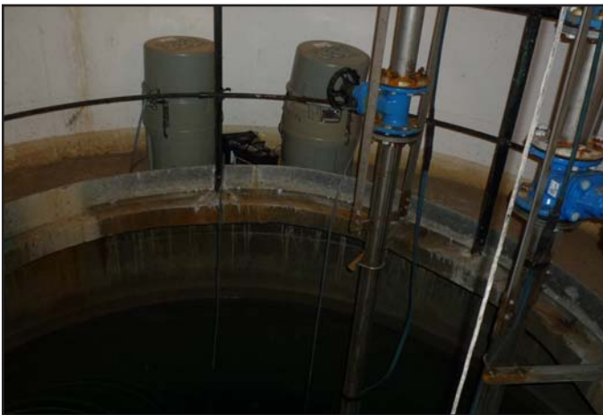
Photographie 3 : Préleveurs automatiques dans le captage de l'Eau Brillante
